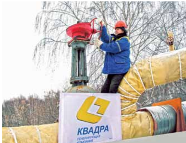
Слесарь по обслуживанию тепловых сетей ООО «Рязанская теплосетевая компания» Николай Хромов открывает задвижку трубопровода
