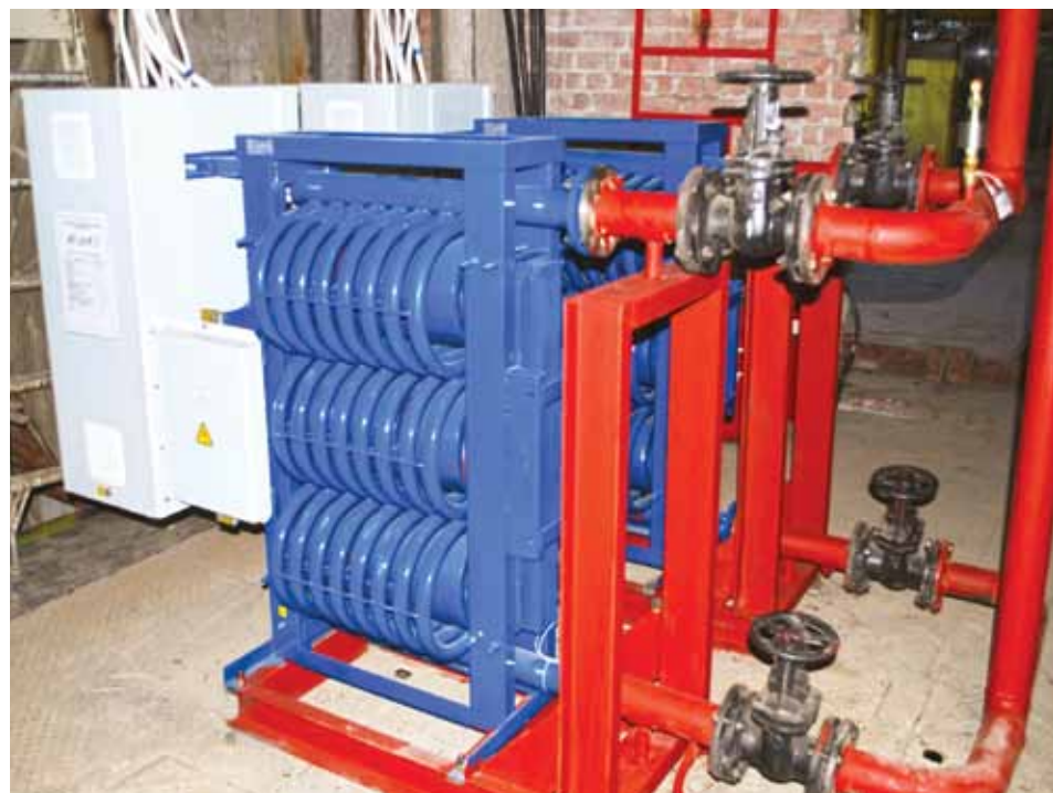
Индукционные подогреватели резервного топлива на водогрейных котлах
