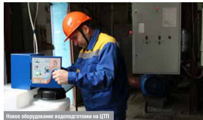
Новое оборудование водоподготовки на ЦТП
