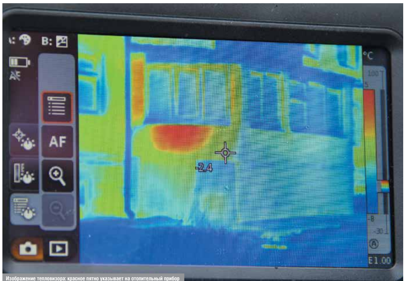
Изображение тепловизора: красное пятно указывает на отопительный прибор
